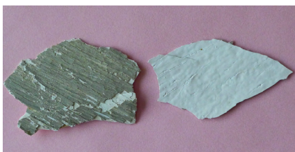
Farbablösung mit weissem Altanstrich auf der Rückseite
