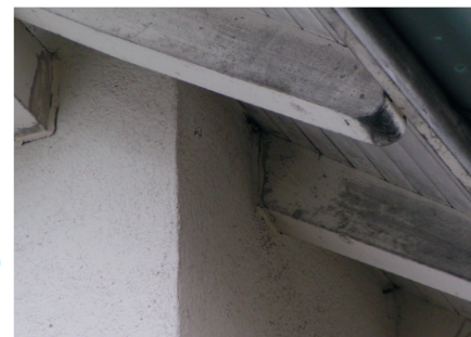
Pilzbefall auf Ölanstrich
