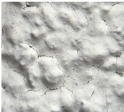
Durch den Zusatz von 2% Acrylfasern können feine Haarrisse im Putz zugeschlemmt werden.
