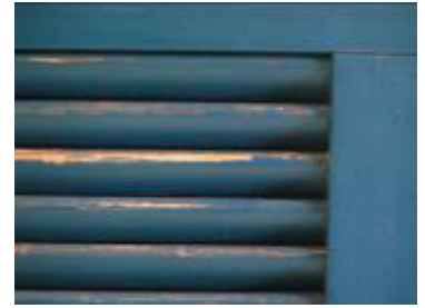
Acryllack (dauerelastisch) Schichtbildend aufgetragener KH-Holzschutzgrund (auf abgewitterte, abgelagte, alte Fensterläden) führt an den kritischen Stellen zu Ablösungen!
