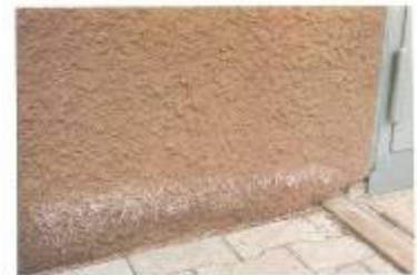
Ausblühungen auf einem Silikatputz infolge aufsteigender Feuchtigkeit!
