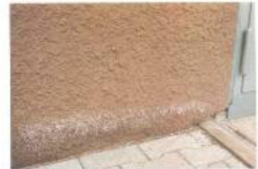
Ausblühungen auf einem Silikatputz infolge aufsteigender Feuchtigkeit!
