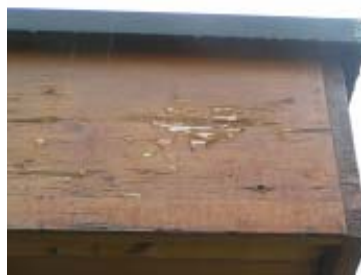
Glacis épais à base acrylique Début d'écaillage le long des fissures dans le bois.
