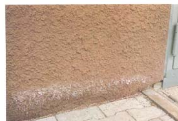
Efflorescences provoquées par l'humidité ascendante sur un crépi aux silicates!
