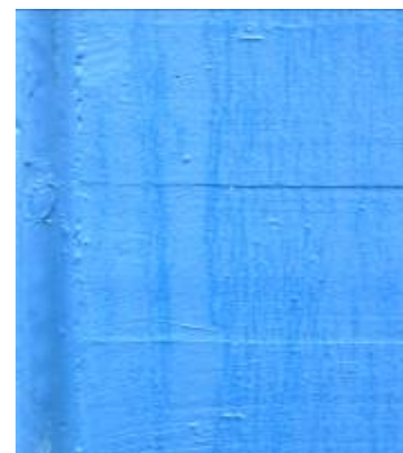
Striation sur un revêtement de dispersion bleu suite aux traces laissées par l'écoulement de l'eau de condensation!
