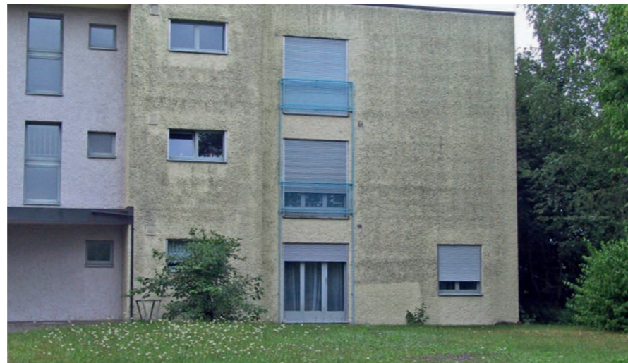
Une façade de 35 ans avec du crépi synthétique
